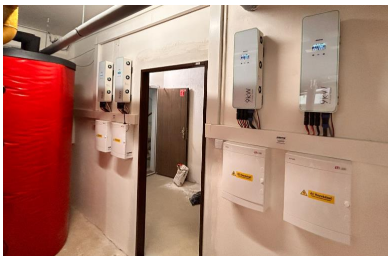
Zapojenie 4 jednotiek pre ohrev vody v bytovom dome
