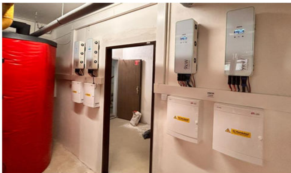
Elektroinstalace 4 jednotek ohřevu vody v bytovém domě
